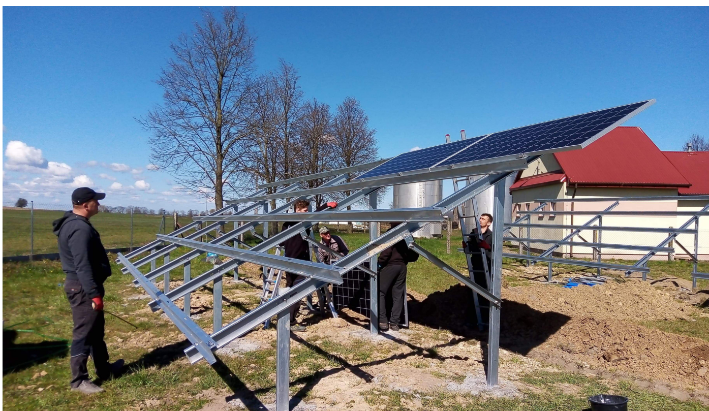
Montaż paneli fotowoltaicznych przy stacji uzdatniania wody w Kumelsku wpłynie na zmniejszenie zużycia energii elektrycznej na tym obiekcie
