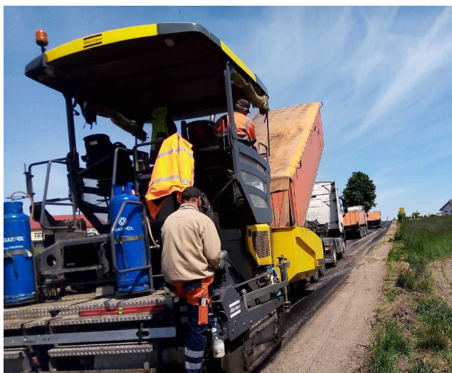
Asfalt na drodze gminnej w Zabelu
