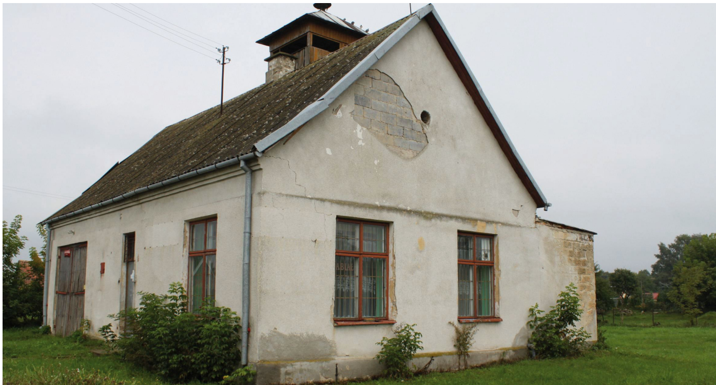
Dawna remiza w Wincencie - stan przed rozpoczęciem remontu
